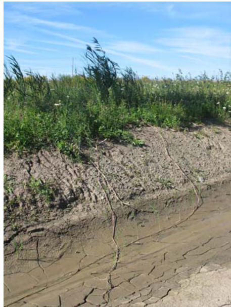
Une image vaut mille mots : propagation végétative (stolons) du roseau dans un fossé de drainage fraîchement creusé le long de l' autoroute 30 , à Saint-Constant. Si rien n'est fait pour implanter rapidement dans le fossé et sur les talus des végétaux compétitifs, ce fossé sera rapidement envahi par des massifs denses de roseau commun (photographie : P. Boivin).
